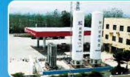
Заправочная станция LNG
