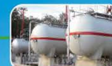
Станция хранения и распределения LPG
