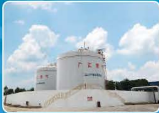
Резервуар для хранения для установки сжижения
