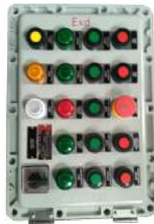
Взрывозащитный шкаф на объекте
